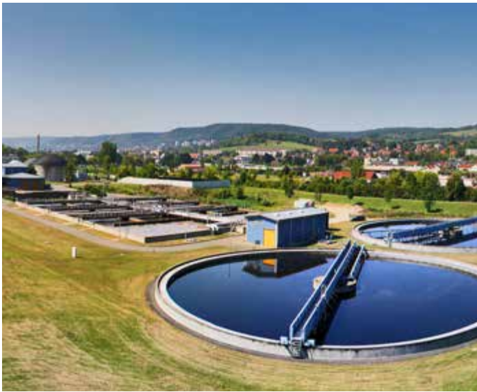
Energieautarke Kläranlage Jena
